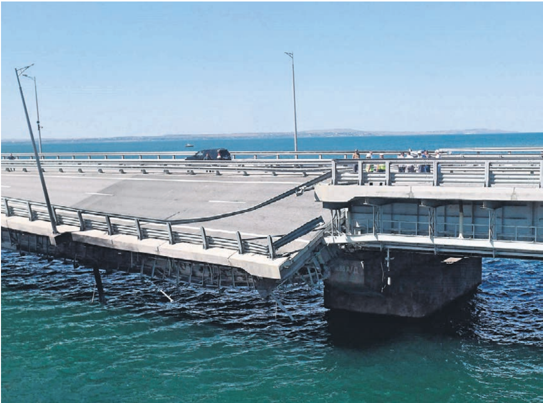
В результате теракта были повреждены пролеты Крымского моста, связывающего Керчь и Тамань ФОТО КОНСТАНТИНА МИХАЙЧЕВСКОГО / РИА НОВОСТИ
