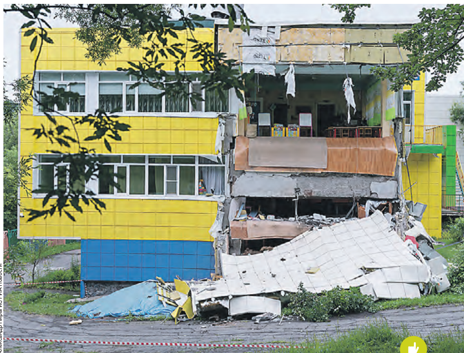
30 июля. Поврежденный детский сад в Петропавловске-Камчатском
